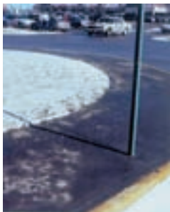
شکل ۸ استفاده از سدیم کلرید برای کاهش نقطه ی ذوب یخ به منظور ذوب کردن یخ سطح جاده ها
